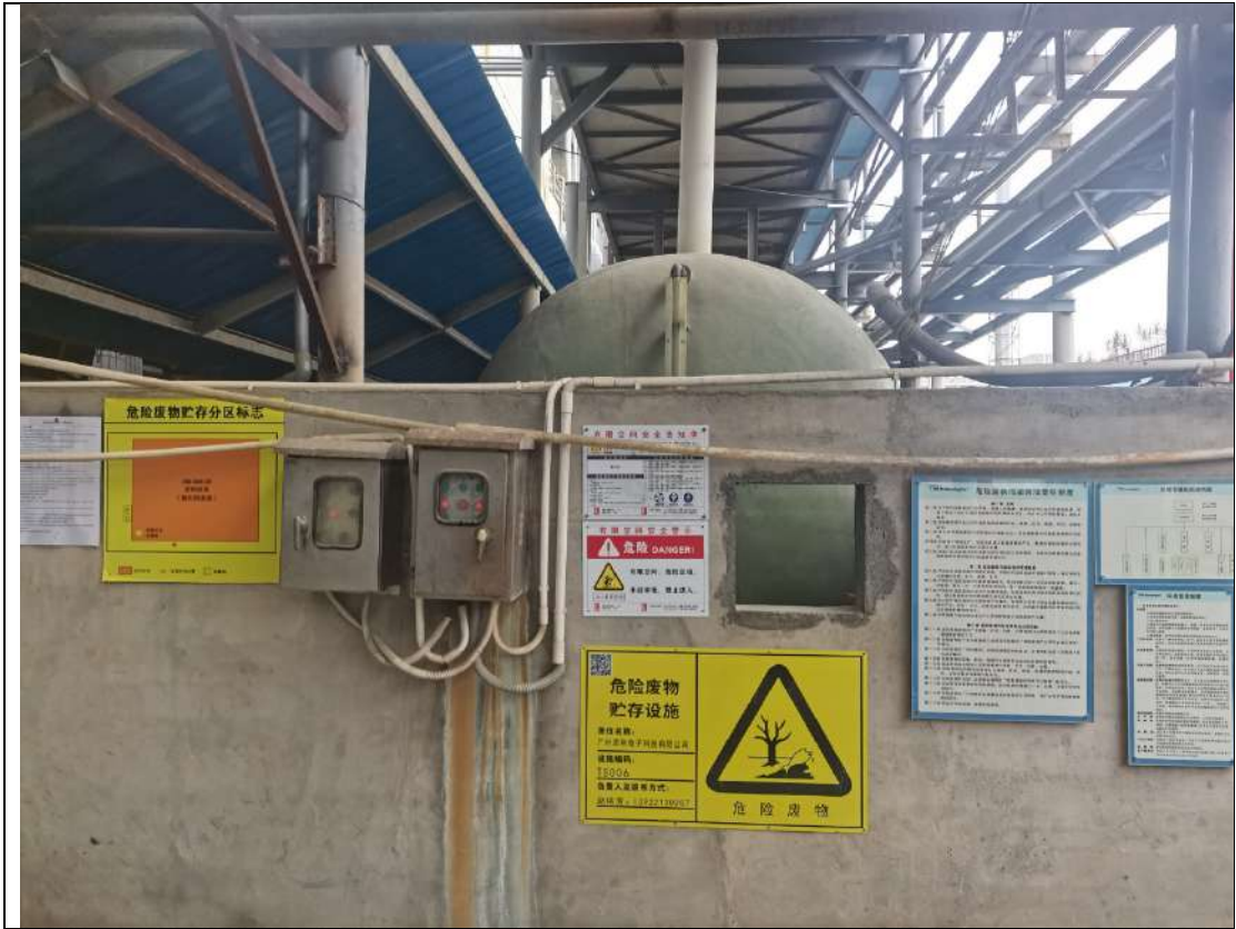
含镍废液贮存罐↑
