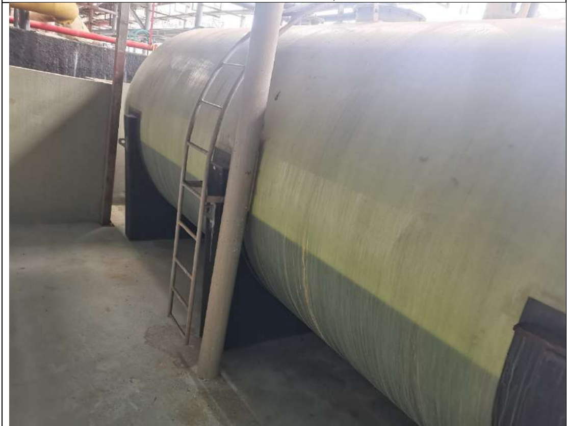
蚀刻废液贮存罐↑
