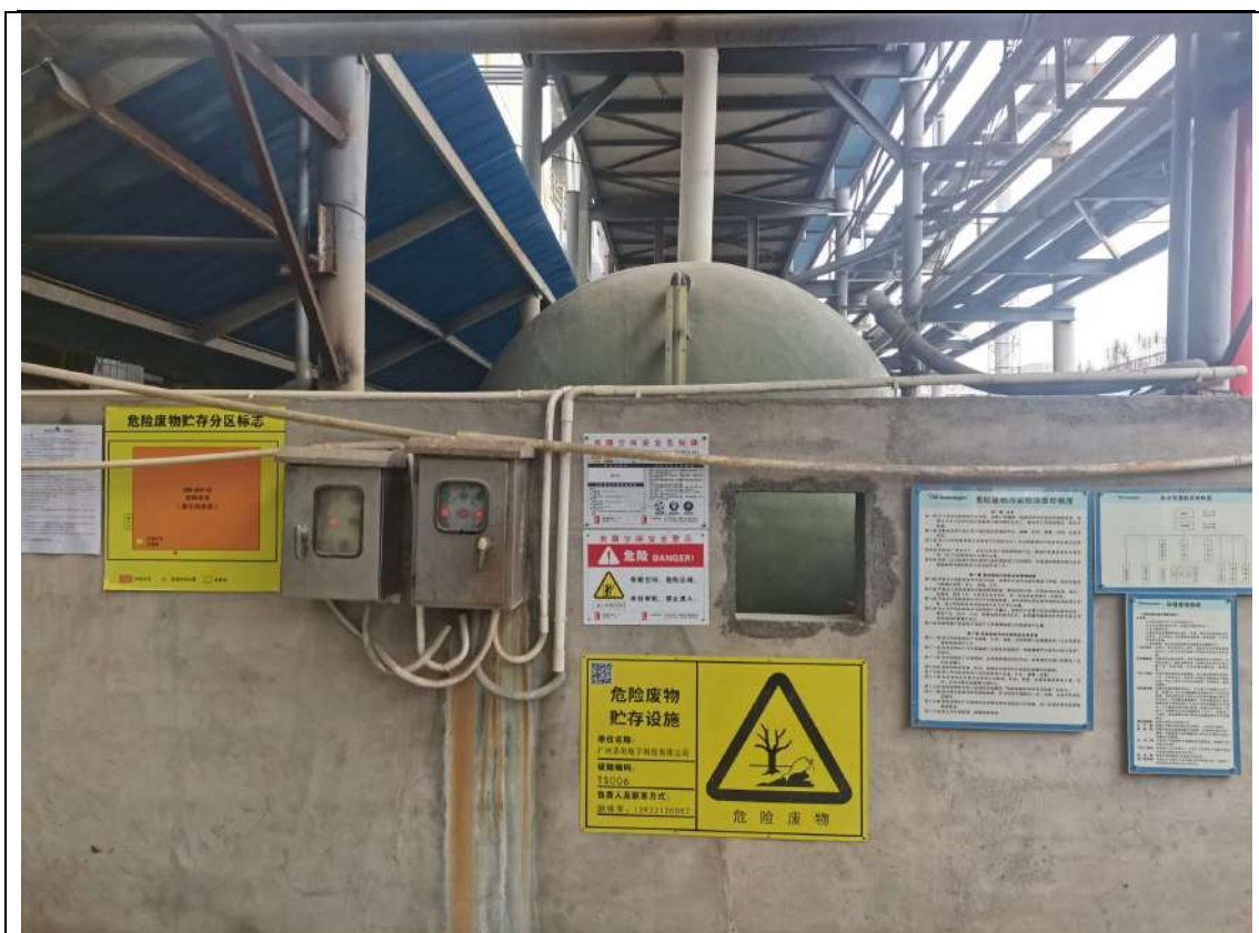
含镍废液贮存罐↑
