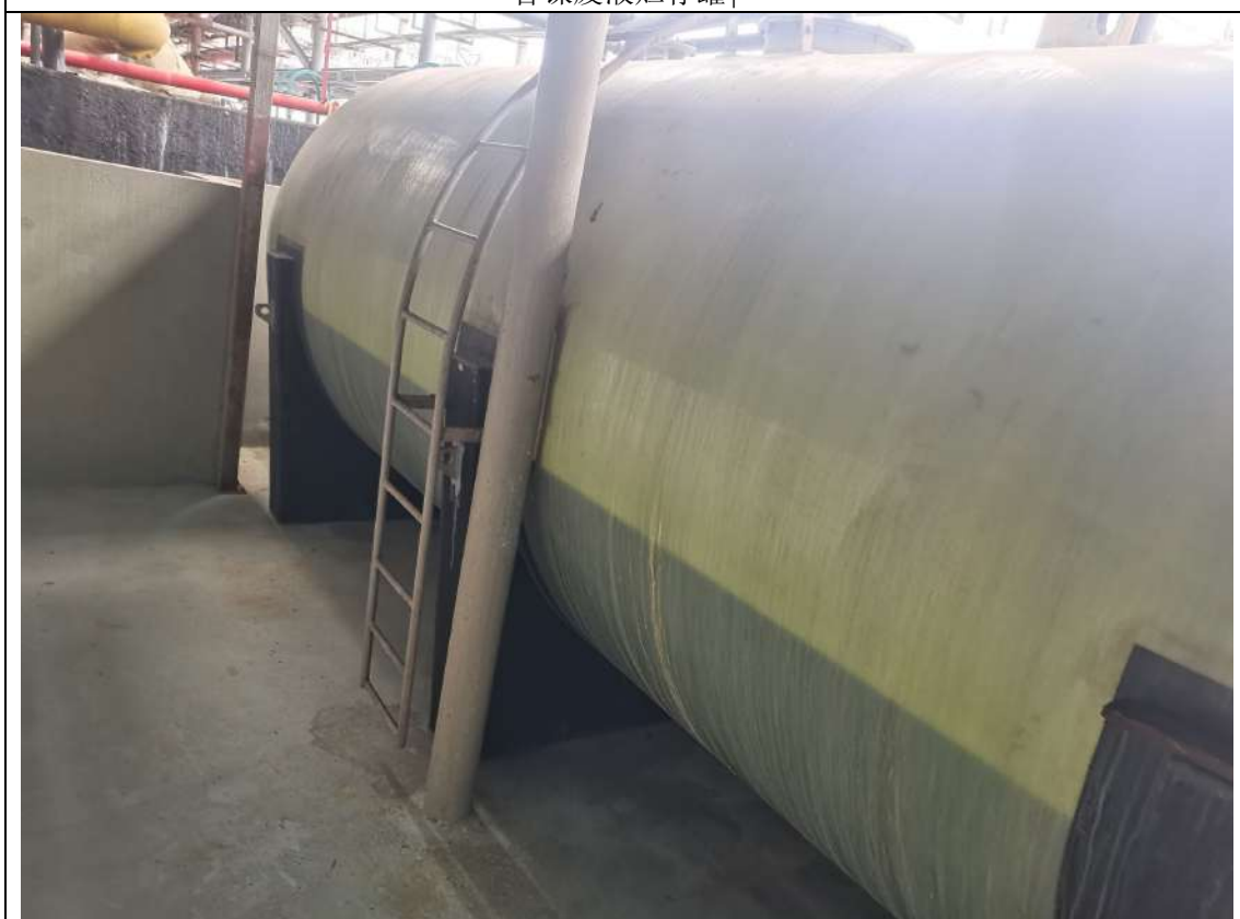
蚀刻废液贮存罐↑
