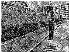
巡查人员发现废水管道泄漏
