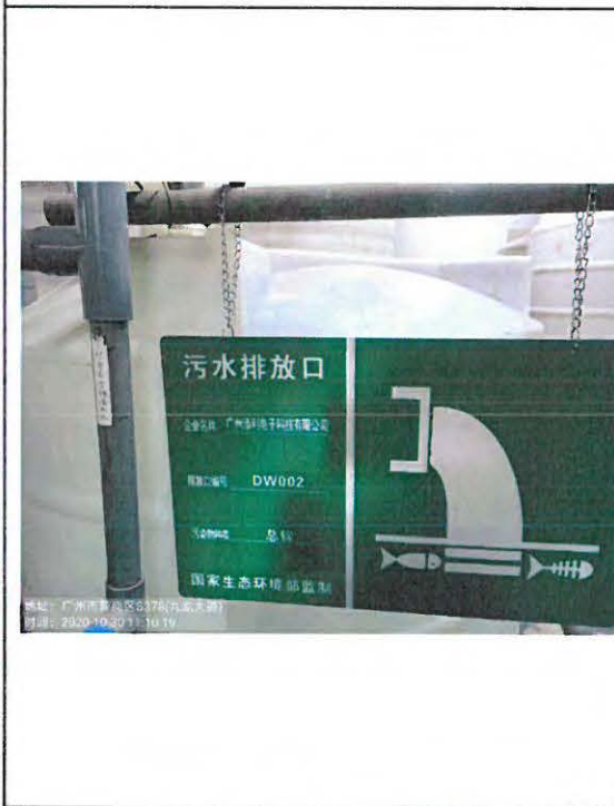
废水排放口 DW002 标志牌
